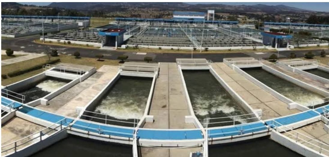
Planta potabilizadora Los Berros, parte del Sistema Cutzamala.
